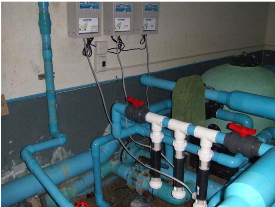
ภาพการติดตั้งในห้องเครื่องของโรงแรมชีวาธรรม สระขนาด 430 คิว(Out door)
