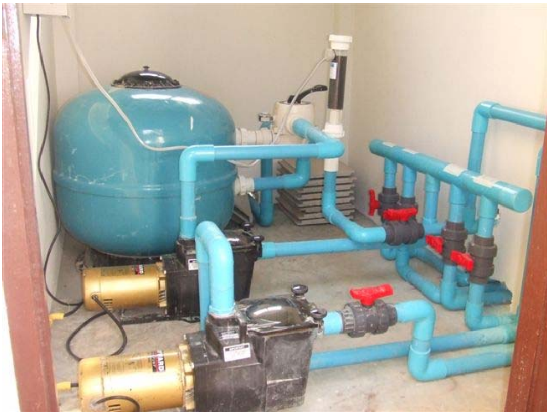
ภาพห้องเครื่องที่โรงแรมสายลม
